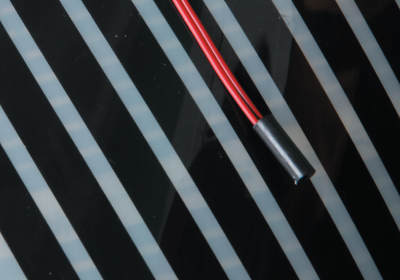
Рис. 22. Установка датчика температуры пола SF 4x15
